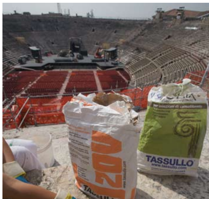
ARACO ha visitato il cantiere pilota TASSULLO presso l'Arena di Verona; nell'immagine un momento dei lavori di restauro sulle gradinate romane
